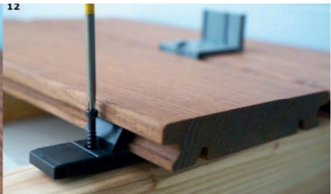
12. Nun die Dielen mittels Schrauben u. Verbinder an der Unterkonstruktion festschrauben. Die Schritte 7 bis 12 wiederholen bis alle Dielen mit der Unterkonstruktion verschraubt sind.
